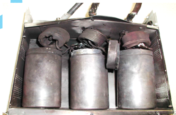
شکل ۱۰- آسیب دیدگی خازن‌ها بر اثر هارمونیک‌های مراتب بالا
